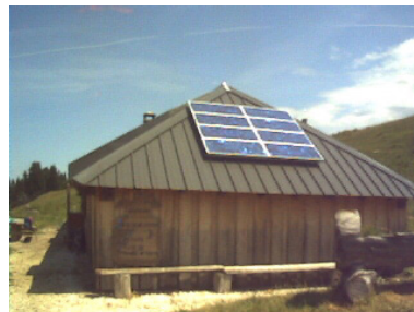
Panneaux solaires en surépaisseur sur la toiture
