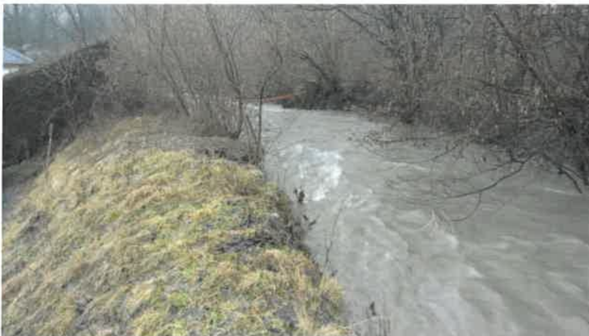
Très faible revanche lors des crues du Nant d'Arvillon, au droit des habitations
