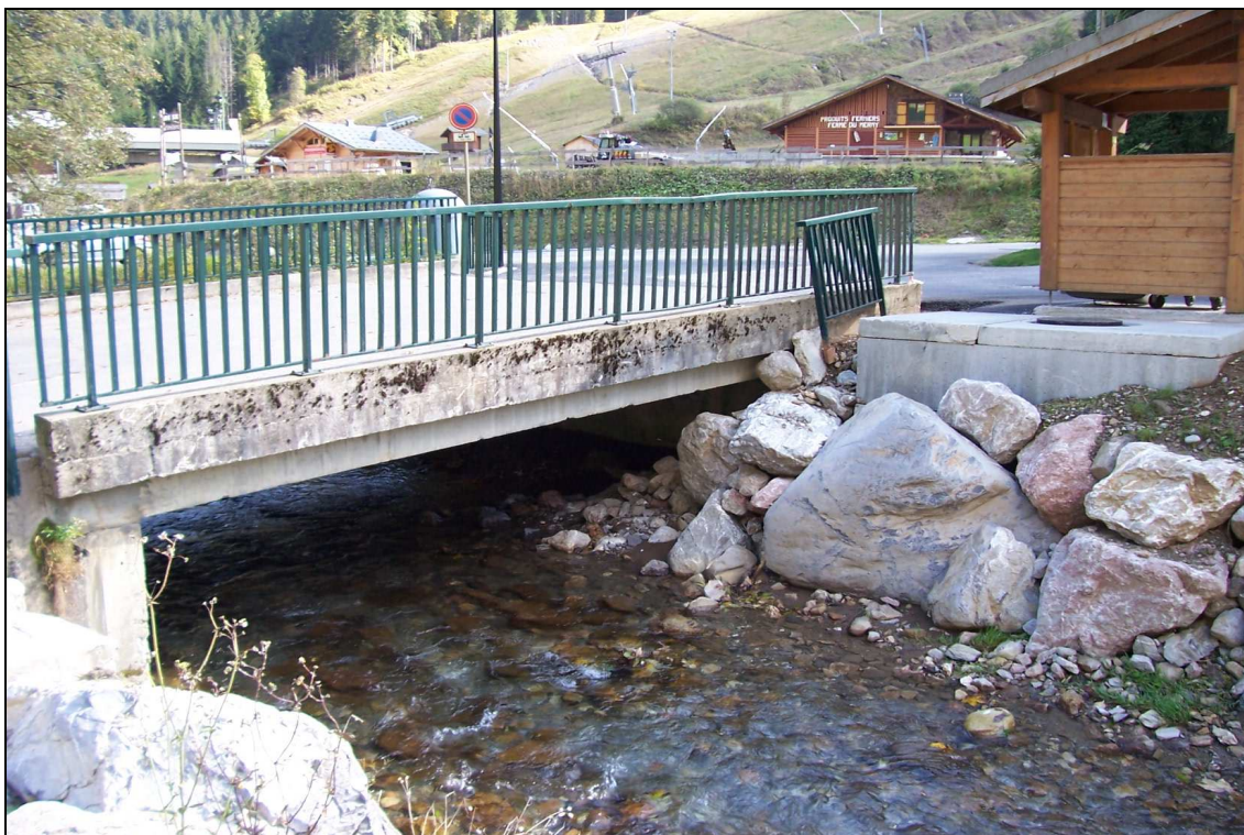
Photographie 1: Le pont de Mergy. la section du pont est réduite suite à l'aménagement d'un bassin. (photo Alp'géorisques octobre 2005).
