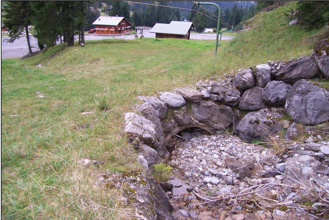
Photographie 4: Buse complètement saturée par les matériaux sur le Ruisseau des Combes à Pré la Joux (photo Alp'géorisques septembre 2005)
