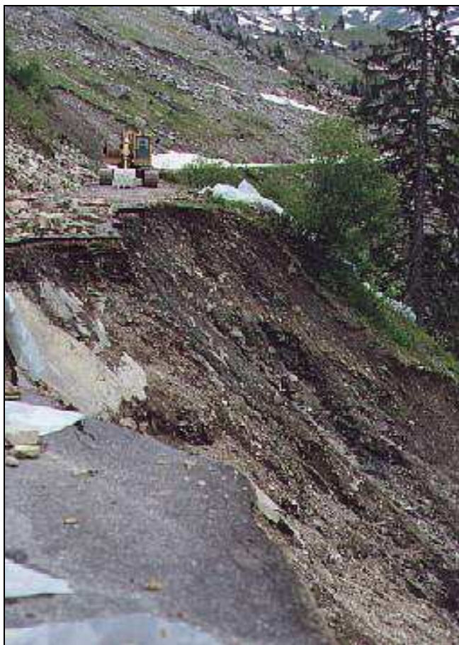
Photographie 6: La route départementale 228 emportée par un glissement de terrain en 1999, valdabondance.com, mai 1999,
